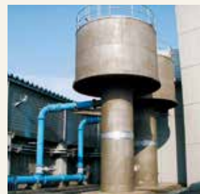
高度浄水処理 オゾン接触槽
