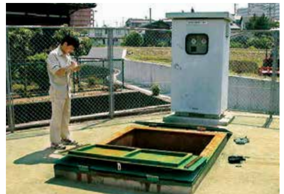
地下約180mから地下水をくみ上げる深井戸
