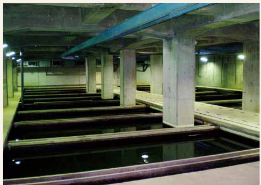
地下にある凝集沈殿池
