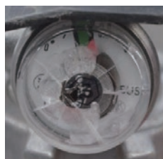
× 指示圧力計の損傷
