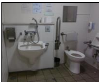
駅構内の多目的トイレ
