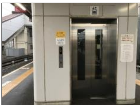
駅構内のエレベーター
