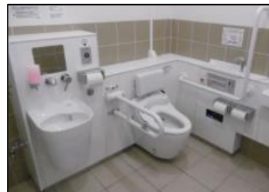
公園内の多目的トイレ(明石公園)
