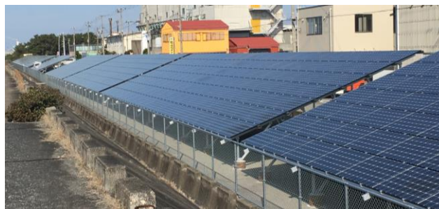
南二見人工島の太陽光発電設備
