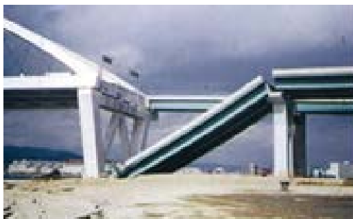
出典：被災事例・落橋（1995年阪神・淡路大震災）
