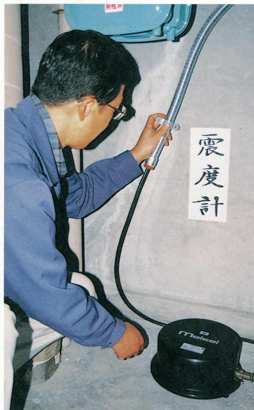
消防本部庁舎1階に設置された震度計のセンサー部
