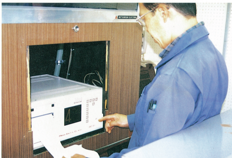
センサーが感知した揺れはデータ化され、電話回線を通じて大阪管区気象台へ送信される(消防本部庁舎)
